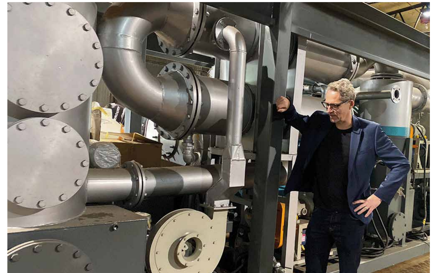
Joakim Erlandsson inspekterar pyrolysmaskinen.
